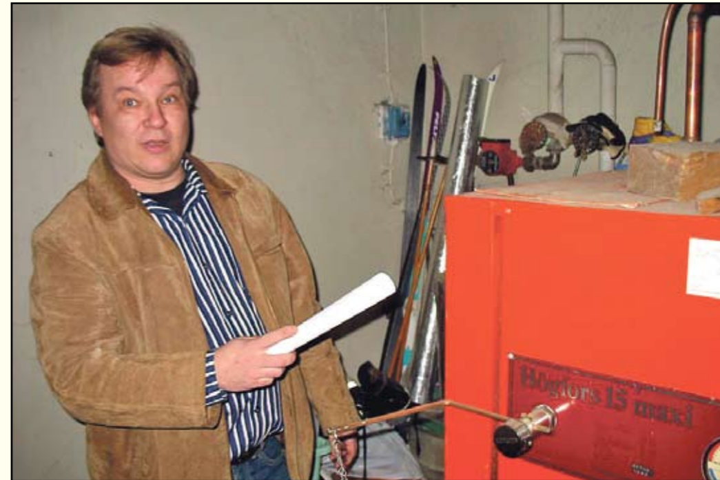
Uuden lämpöpumppujärjestelmän mitoitus vaatii aina tutustumisen kohteeseen, sanoo Pekka Ojala.
